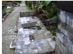
地震により倒壊したブロック塀
