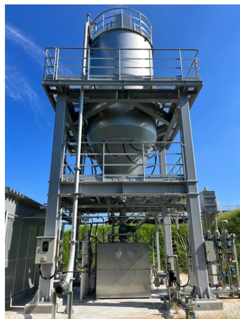
粉末活性炭注入設備
