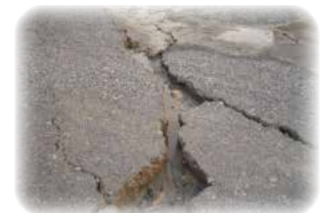
東日本大震災後の古河第七小学校前の地割れ
