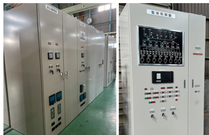
▲屋内キュービクル(左)と監視制御盤(右)
