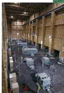
霞ヶ浦揚水機場内部
