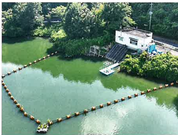
南椎尾調整池 取水設備
