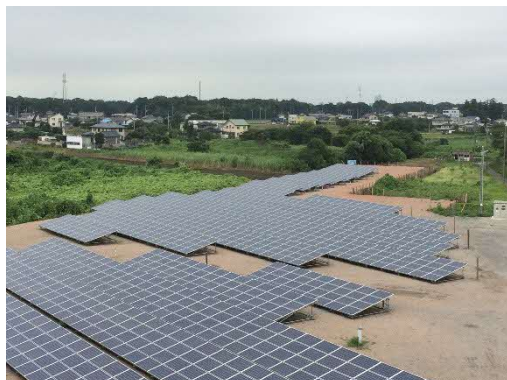
地上設置型太陽光発電設
