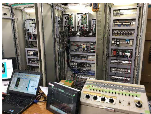
省エネインバータを活用した 制御盤の設計・製作
