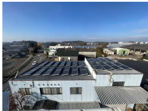
屋上太陽光発電設備
