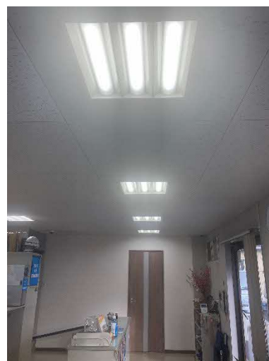
事務所 LED 照明設備
