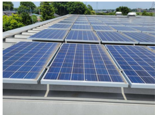
<太陽光発電システム>
