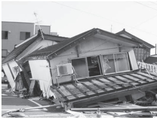
▲新潟中越地震で倒壊した家屋の様子①
