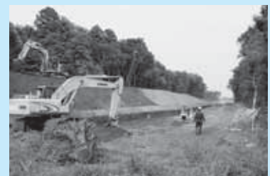
▲急ピッチで整備が進む「筑西幹線道路」(国道4号線バイパスの柳橋北交差点付近)
