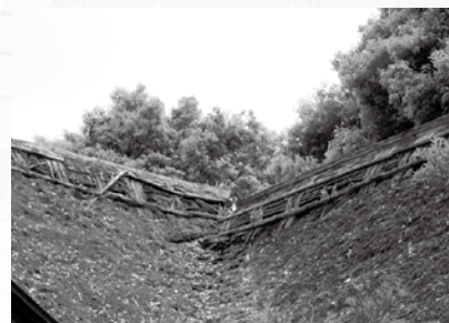
▲損傷の激しいかやぶき屋根の棟
