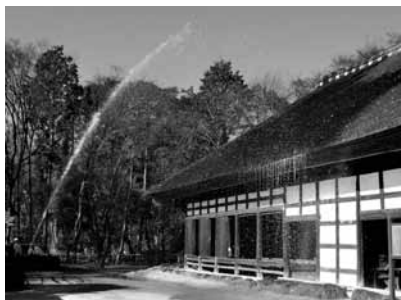
▲民家園内の4カ所に放水銃があります
