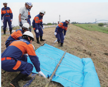
堤防表法面の崩壊と洗掘箇所 の透水防止
