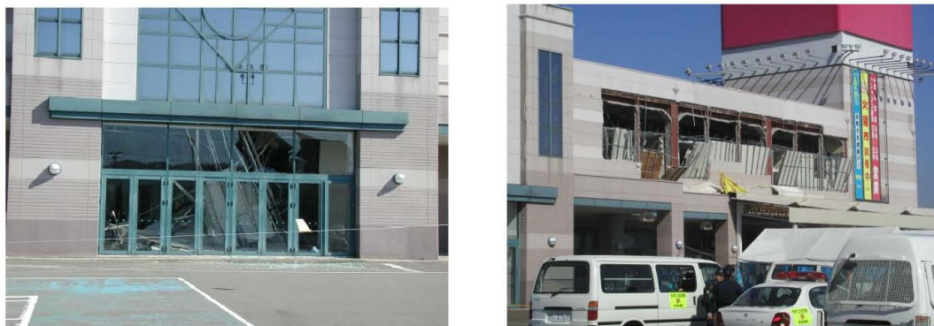
図3-5 天井材・外壁が崩落したRC造大型店舗（新潟県中越地震）
