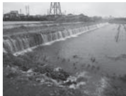
豪雨時、大堤排水路の越水状況
