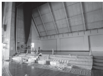
雨漏りがひどい古河体育館
