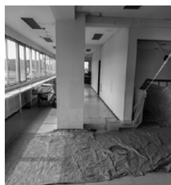
雨漏り等の改修予定の管理棟
