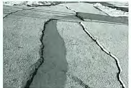
地震による道路の亀裂
